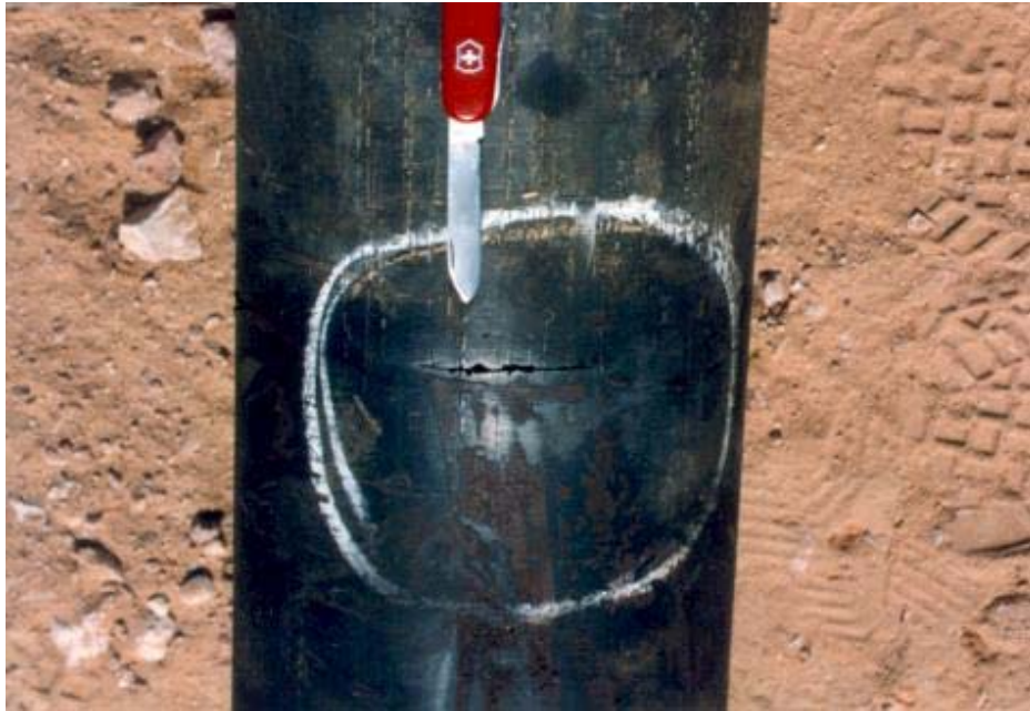
Figura - Falha típica de fadiga
